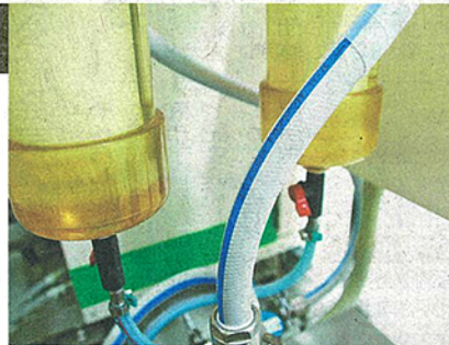
透析装置に接続したトヨックス製ホース
